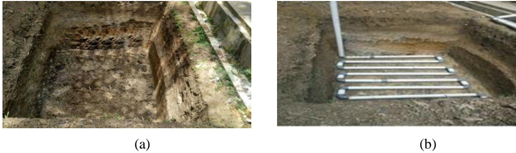
Gambar 2. (a) Lokasi dan (b) alat penukar kalor udara-tanah yang dirakit
