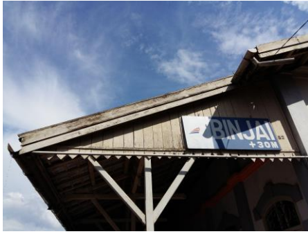
Gambar 15. List-plank pada Atap Peron Stasiun Kereta Api Binjai
