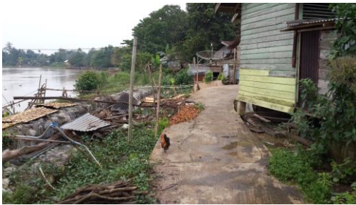
Gambar 1. Kondisi Bangunan di Sepadan Sungai
