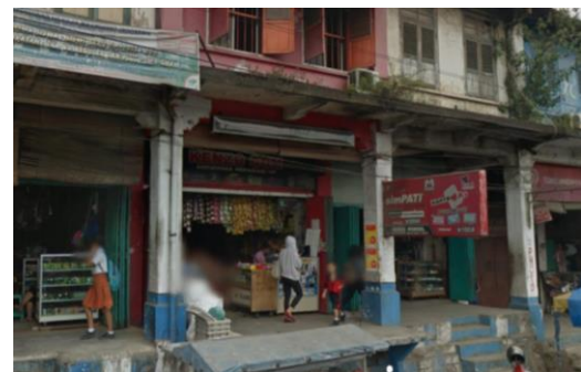
Gambar 11. Kolom pada Bangunan Ruko Cina Melayu di Pancur Batu Tampak Sudah Tidak Terawat
