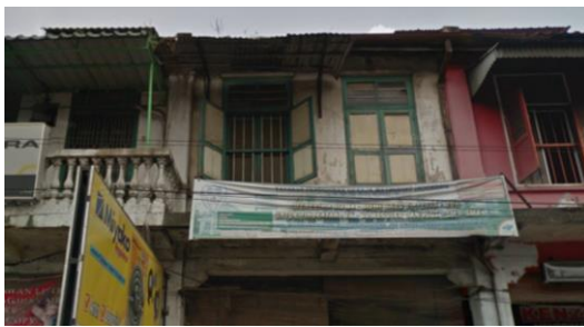
Gambar 8. Kondisi Fisik Bangunan Ruko Cina Melayu di Pancur Batu pada Bagian Jendela
